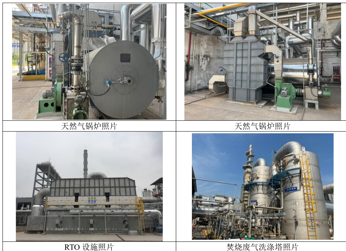
图 4.1-3 废气处理设施照片
