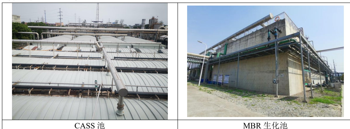
图 4.1-2 污水处理设施照片
